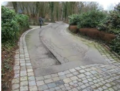
2a) Schlaglöcher Straße Zum Park
