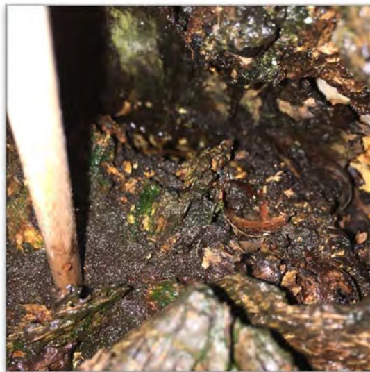
Abbildung 10: Hoher Wasserstand in der Aushöhlung (07.04.2022)
